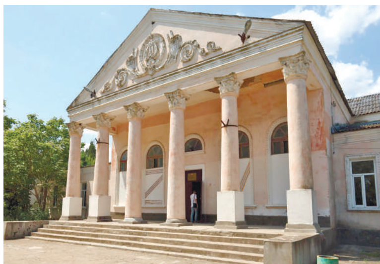
Некогда величественное здание ДК ныне явно нуждается в ремонте.
