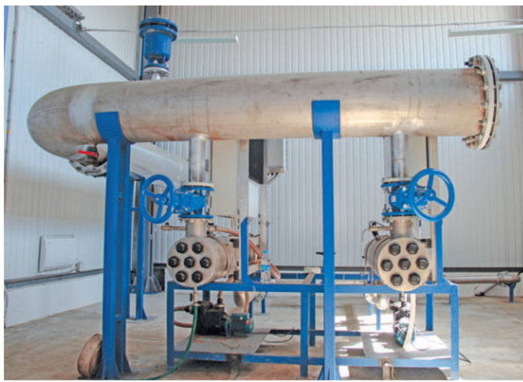
Установка для обеззараживания ультрафиолетом.
