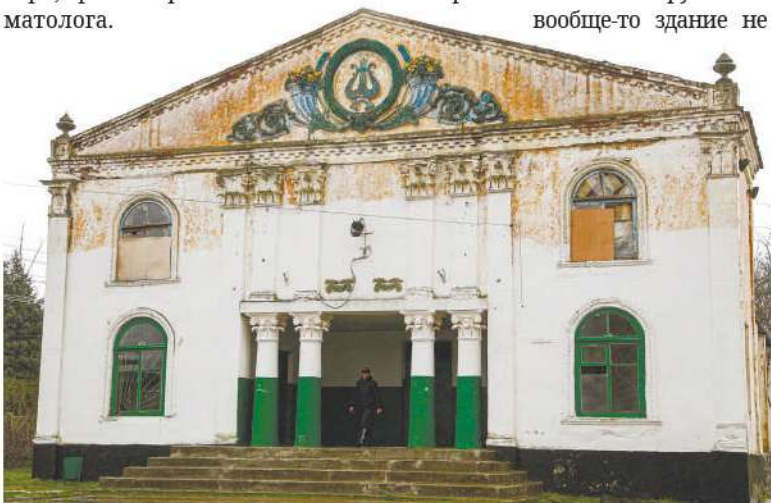
На ремонт Дома культуры финансирование ещё не открыто.
