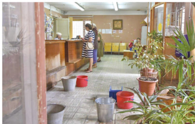
Почте давно требуется ремонт. Вёдра в интерьере – обычное дело.
