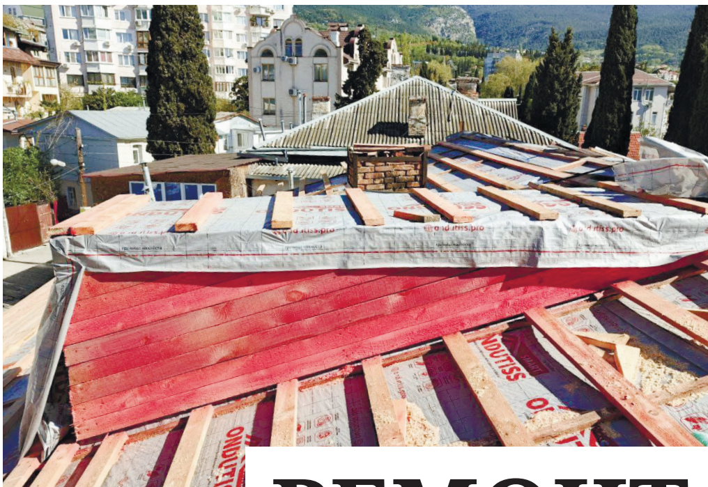
Ялтинские крыши давно нуждаются в ремонте.
