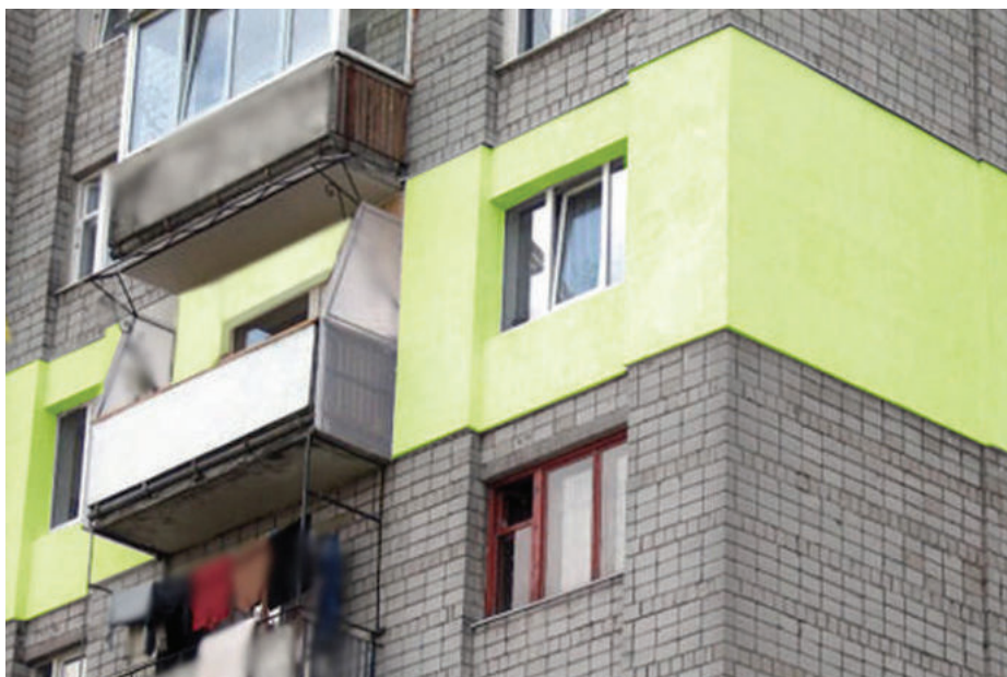
Такие утеплительные «латки» могут стать причиной пожара в доме.
