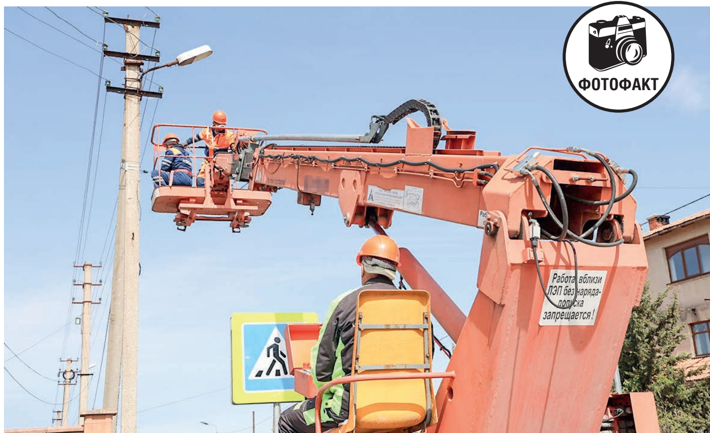
16 апреля, Симферополь. В крымской столице продолжаются работы по восстановлению и модернизации уличного освещения. Фото: Михаил ГЛАДЧУК
