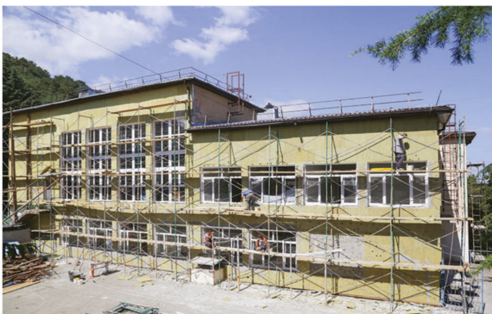
Гаспринская школа строилась в 1988 году, с тех пор капитального ремонта здесь ни разу не было.
