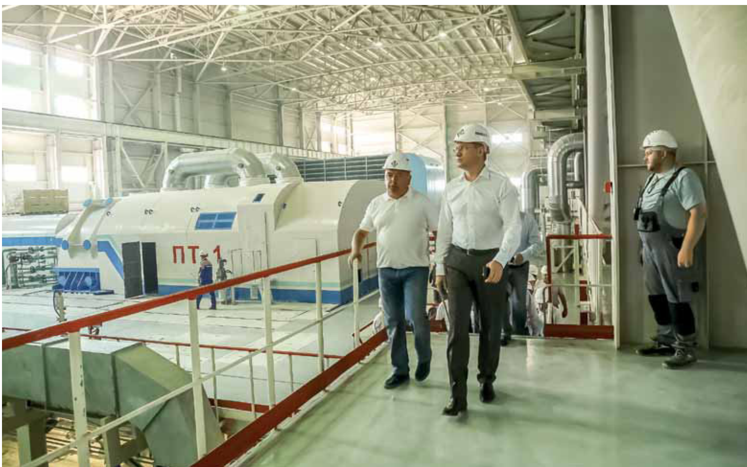
Ещё один новый объект энергоснабжения – Таврическая парогенераторная теплоэлектростанция, строящаяся в рамках федеральной целевой программы в Симферопольском районе. На днях здесь побывал министр энергетики РФ Александр Новак. Фото: Лидия ВЕТХОВА
