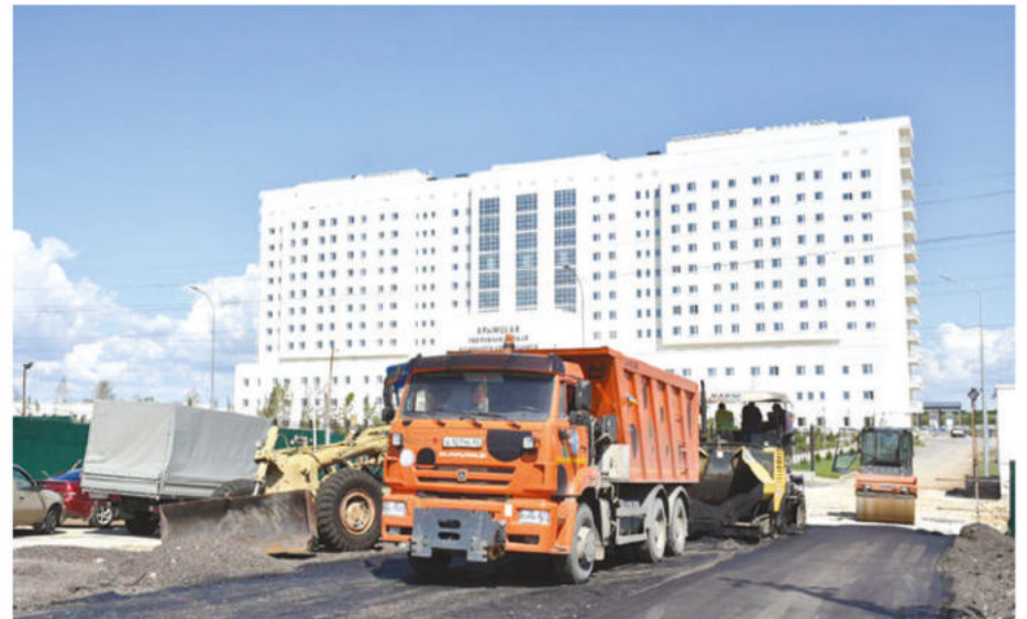
Проверка показала, что на объекте нехватка рабочей силы, оборудования и материалов.
