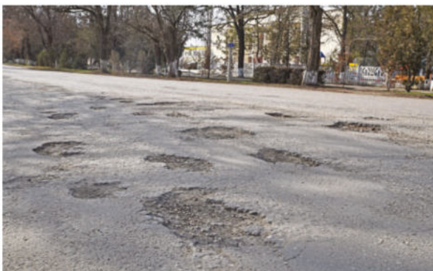
Дороги требуют срочного ремонта.
