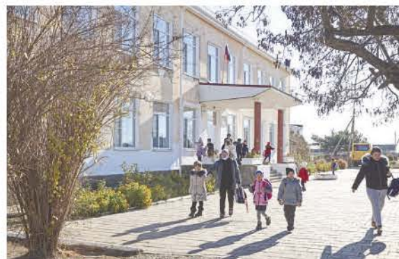
Фасад школы нуждается в ремонте.
